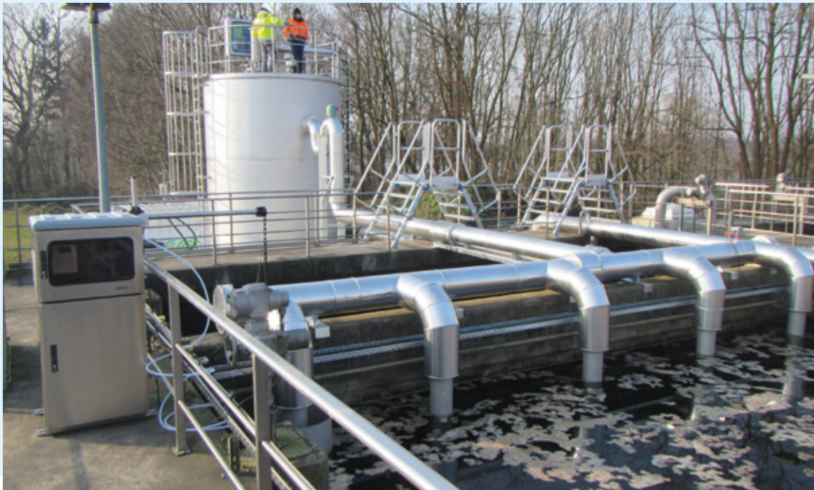
Bild 1 Kläranlage Paderborn: Die biologisch aktivierte Aktivkohlefiltration wird als neuartige Verfahrenskombination getestet
