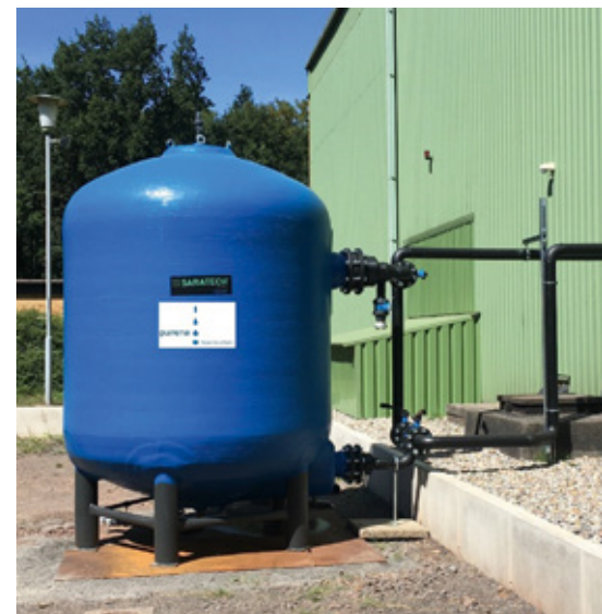
Bild 4 Filterbehälter in Betrieb
