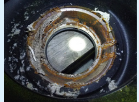
Bild 2 Feuchttücher verursachen häufig Störungen an Abwasserpumpen
