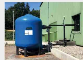
Bild 2 Großpilot mit Saratech Hochleistungsadsorbentien am Wasserwerk Hoya
