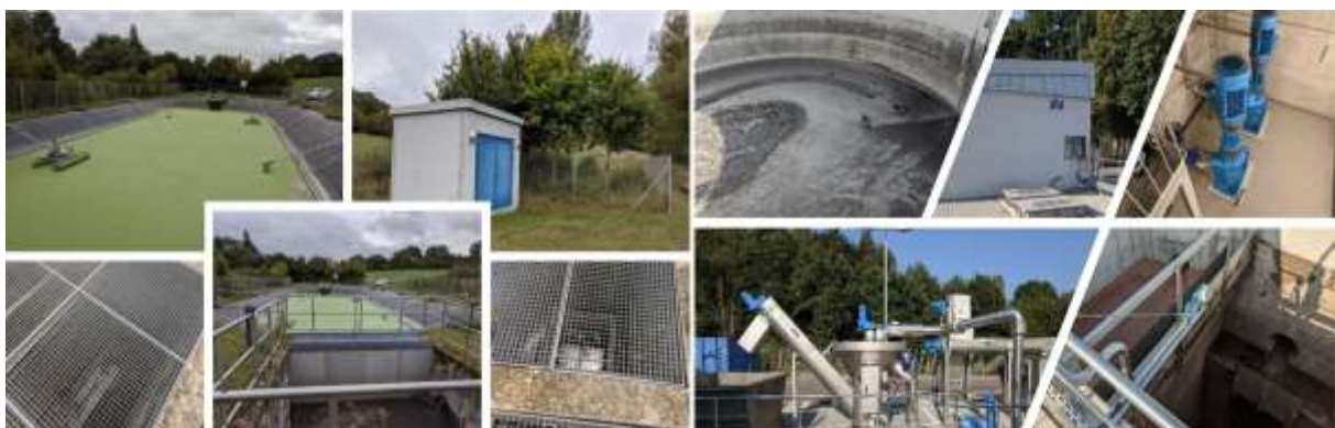
Kläranlage (links) und Pumpwerk (rechts) des Entsorgungsverband Saar
